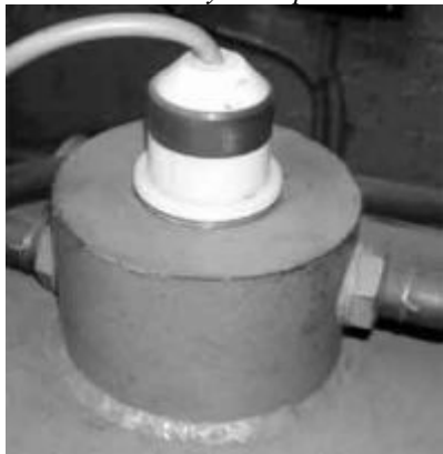
Рис. 3.42. Токоввод с автономным охлаждением
