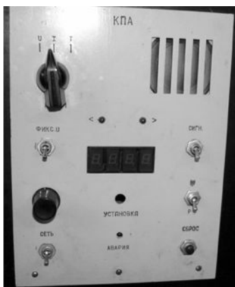
Рис. 3.25. Лицевая панель контроллера управления АТР
